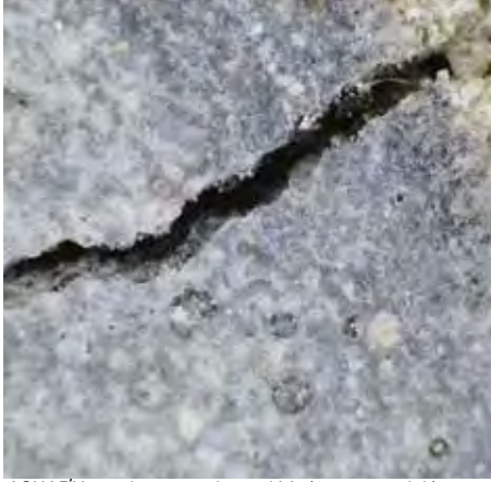
AQUAFIX uygulanmamış beton kırış (0,5 mm çatlak)
