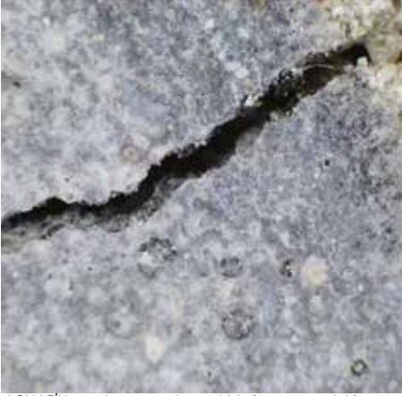
AQUAFIX uygulanmamış beton kırış (0,5 mm çatlak)
