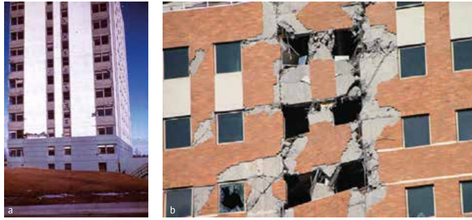
Resim 4. Deprem sonrası oluşan yapısal hasarlar. (a) Perde duvar bağ kirişlerinde oluşan kesme çatlakları. (b) Bağ kirişlerde meydana gelen diğer bir çatlak türü.
