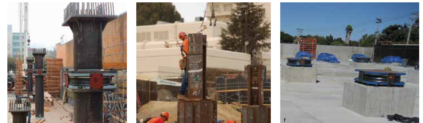
Resim 8. Temel izolatör uygulama resimleri. (a) Dairesel kolon üst bölge bağlantısı. (b) Kare kolon üst bölge bağlantısı. (c) Kolon ve perde duvar üst bölge bağlantıları. (d) Kolon orta bölge bağlantısı. (e) Çelik kolon alt bölge bağlantısı, montaj öncesi. (f) Betonarme kolon alt bölge bağlantısı.
