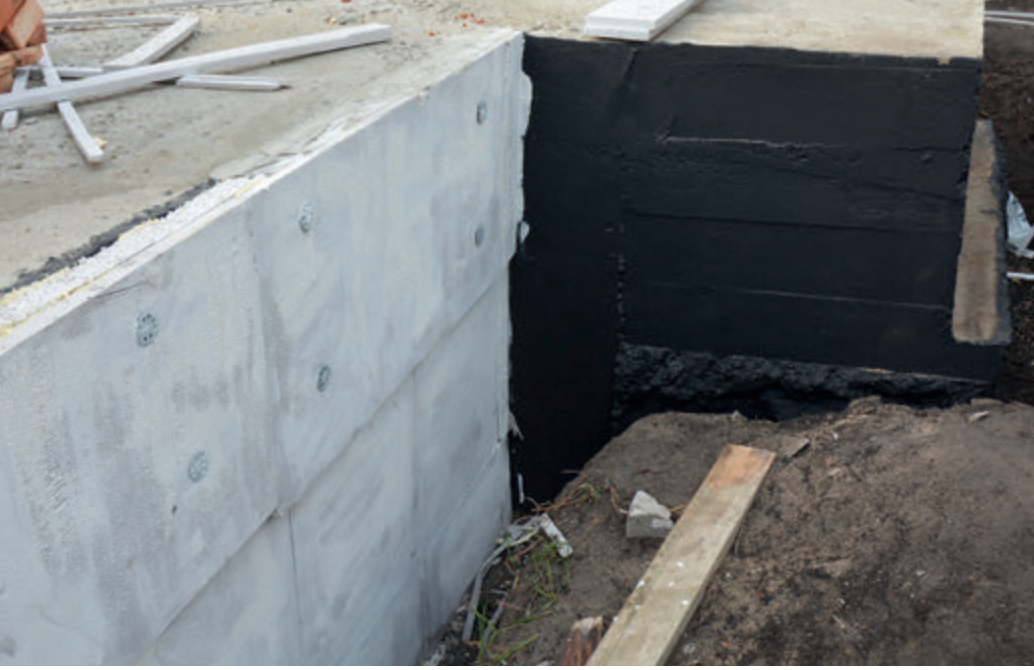
Perde duvarda su yalıtımı
